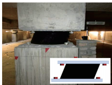
图 15 隔震支座变形
