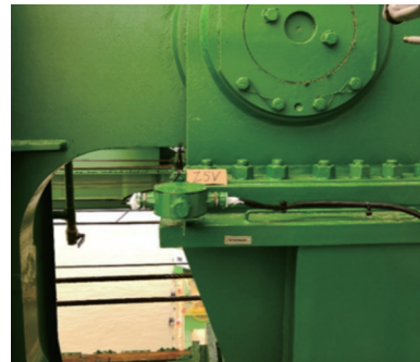
图4 岸桥铰点振动传感器安装位置
